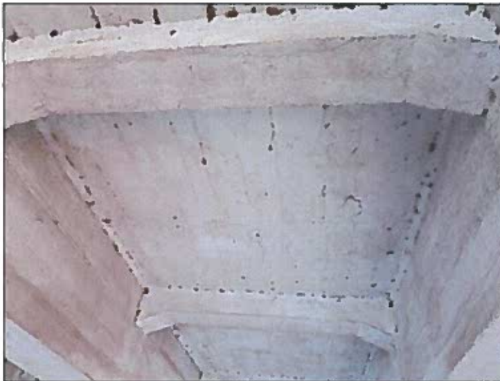
lokální prouchy krycí vrstvy na spodním líci desky mostovky
