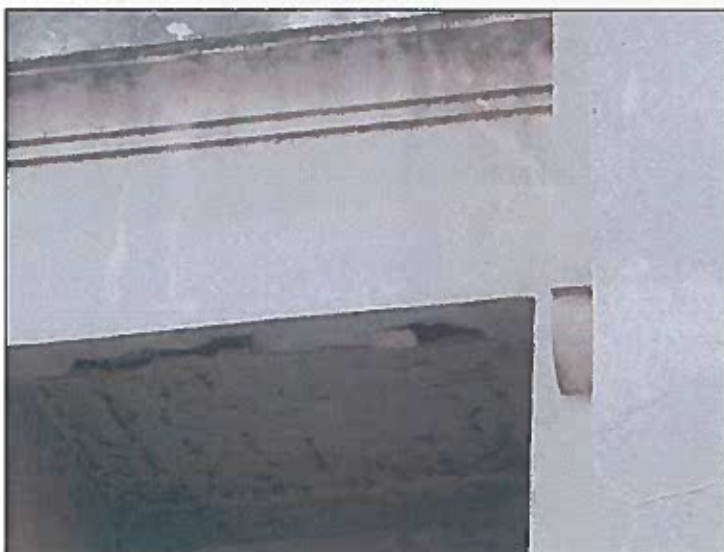
odpadávající krycí vrstva nad korodující výztuží se spodního líce krajního podélníku
