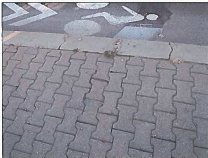
deformace krytu chodníku v oblasti MZ
