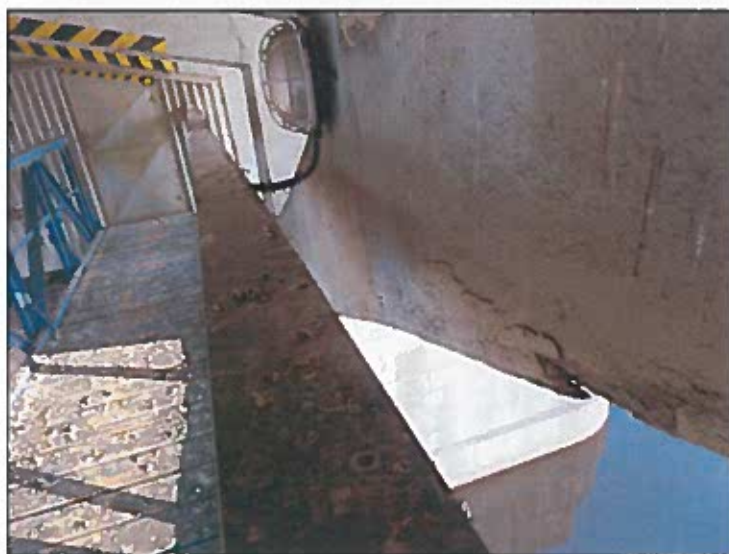
výrazná separac ekrycí vrstvy v hraně oblouku
