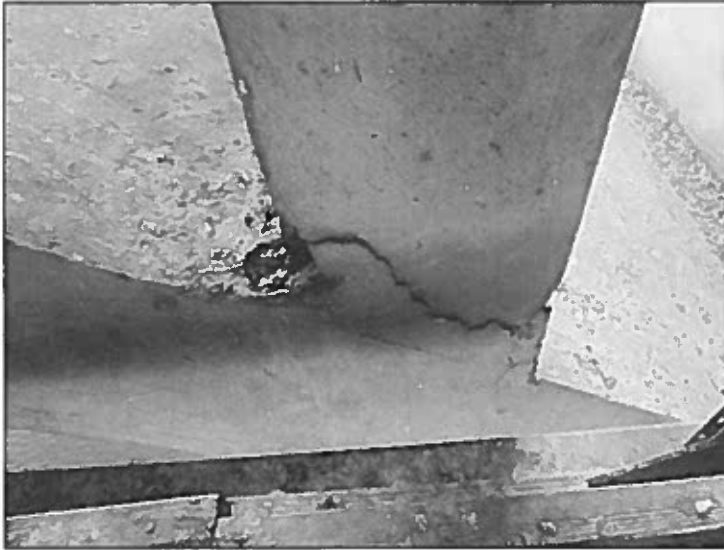
trhliny v krycí vrstvě nad korodující výztuží u stěny v místě kotvení do oblouku
