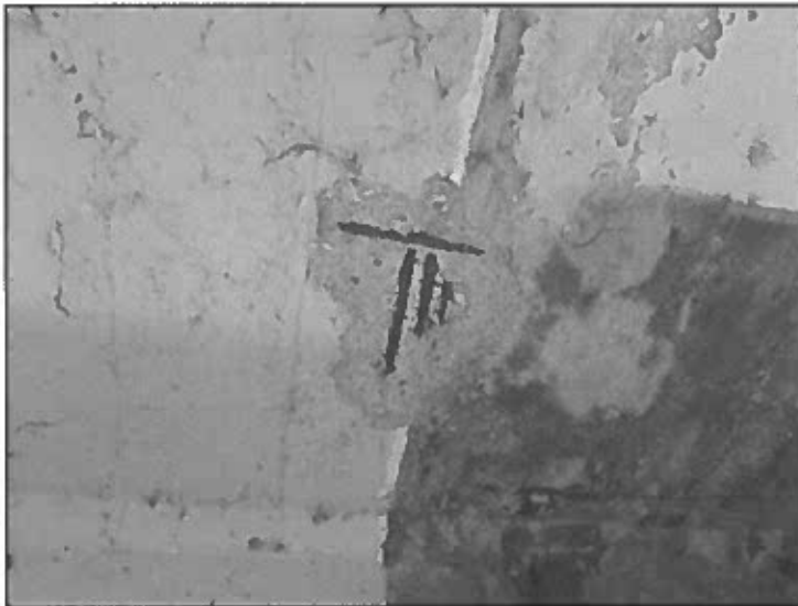
korozí obnažení výztuže na spodním líci desky mostovky v místě odpadlé krycí vrstvy
