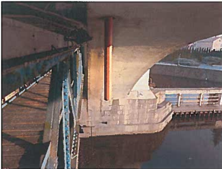
stopy po průsaku na spodním lici obloukového pasu v okolí svodu odvodňovače
