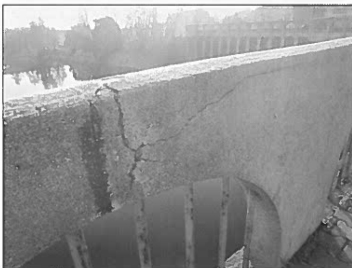
výrazné trhliny v zábradlí
