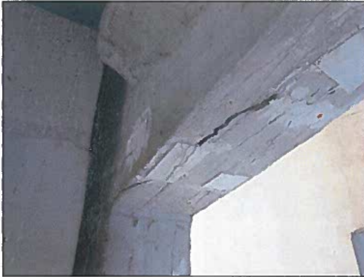
DTTO - detail trhlin způsobených rozpínáním korodující výztuže
