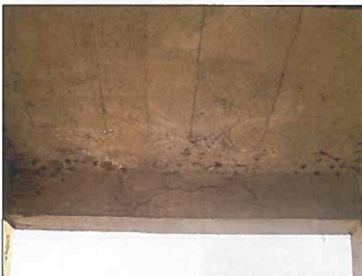
separace krycí vrstvy u krajního podélníku
