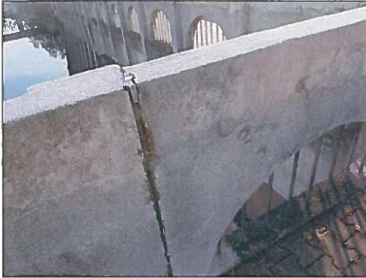
poruchy zábradlí v místě dilatační spáry
