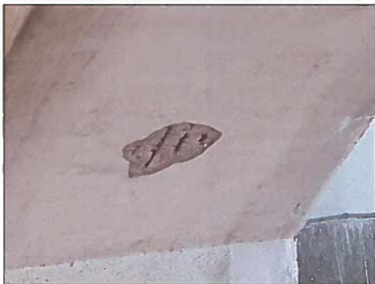
DTTO - detail obnažené korodující výztuže v místě odpadlé krycí vrstvy
