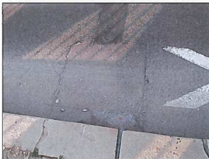
nevhodně provedená oprava EMZ
