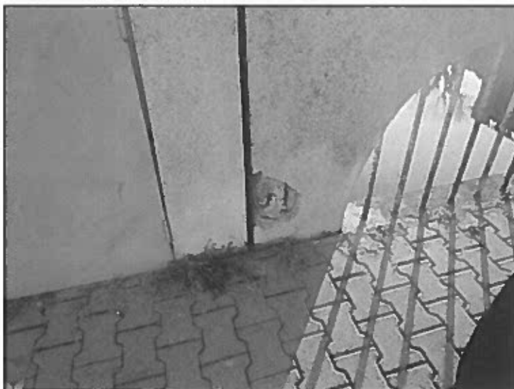
korodující výztuž zábradlí v místě odpadlé krycí vrstvy
