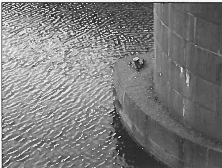
vegetace uchycená v místě spáry v obkladním zdivu pilíře
