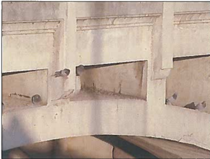
korozí obnažené výztuže stěn nad obloukovým pasem
