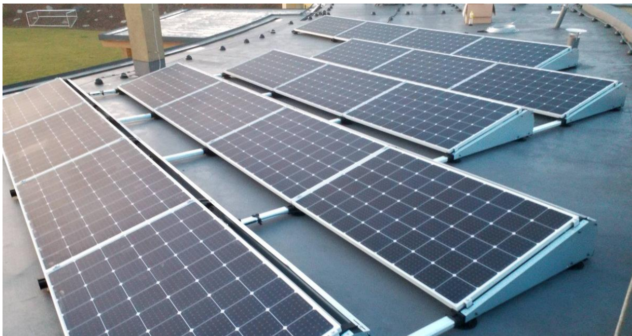
Obrázek 4 Ukázky osazení FV systému
