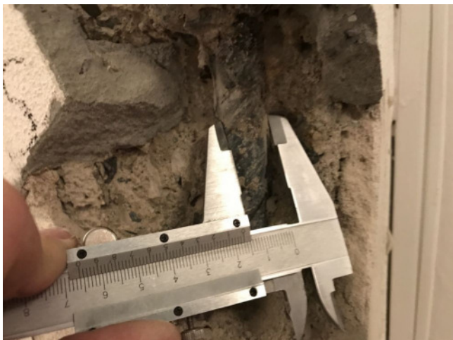
foto/24/ Zjištěný průměr výztuže (16 mm)
