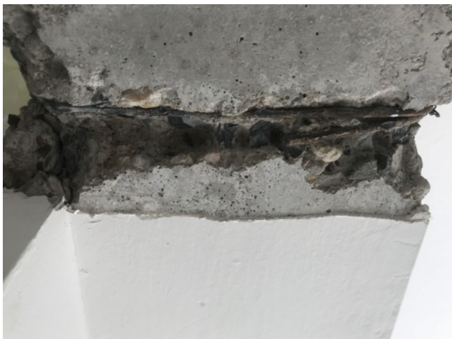
foto/2/ Zjištěná výztuž v průvlaku P1
