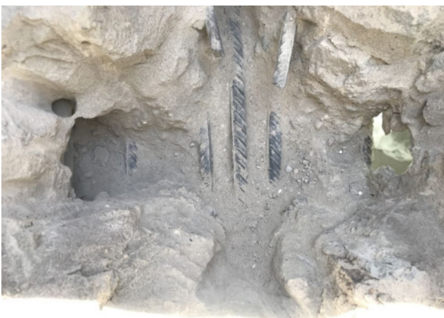
foto/12/ Zjištěná horní výztuž průvlaku
