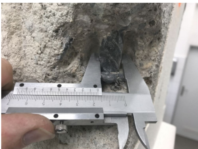
foto/28/ Zjištěný průměr výztuže (16 mm)
