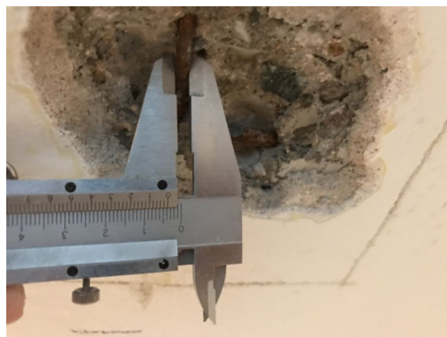
foto/39/ Průměr rozdělovací výztuže sítě (4 mm)
