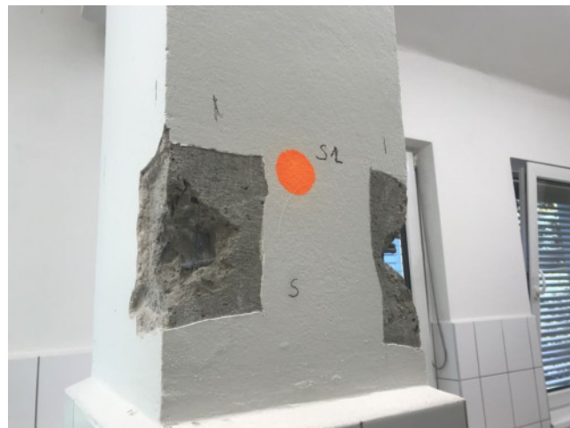
foto/27/ Zjištěná výztuž sloupu S2
