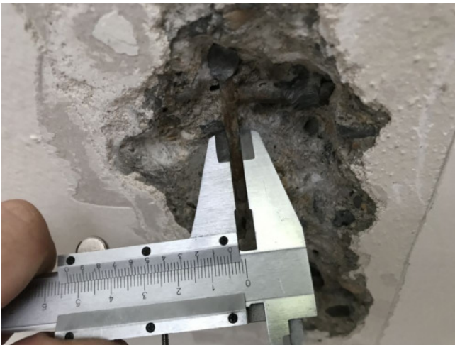
foto/34/ Průměr rozdělovací výztuže sítě (4 mm)
