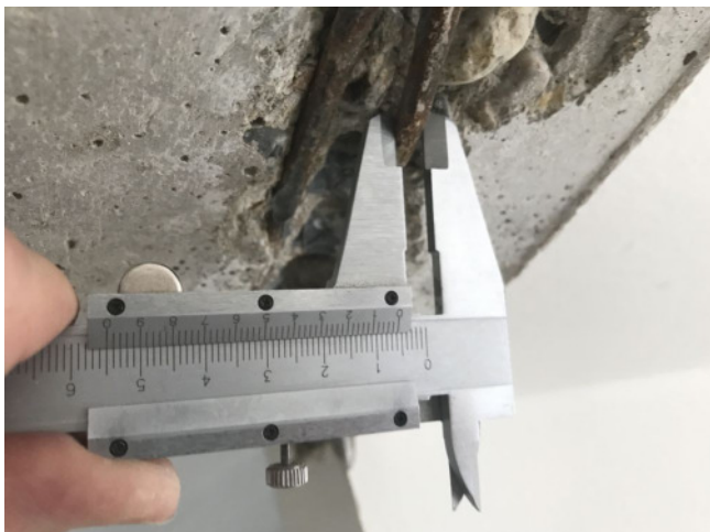
foto/4/ Zjištěný průměr třmínků (6 mm)
