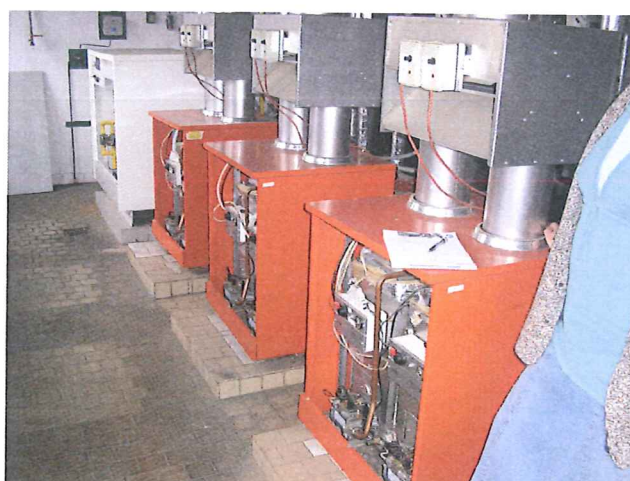
Instalované kotle na ZP
