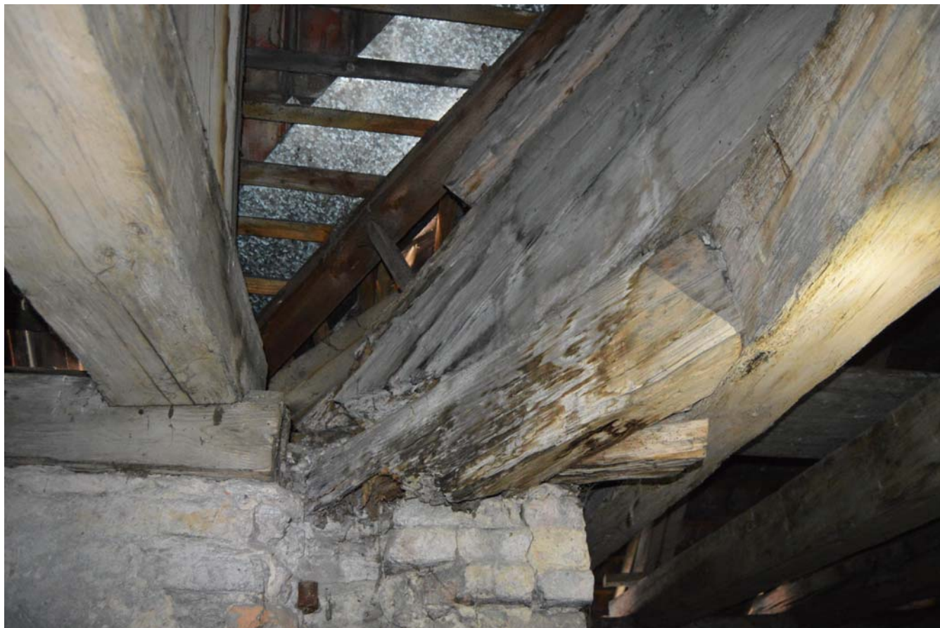
11. Poškozená úžlabní vazba č. 36
