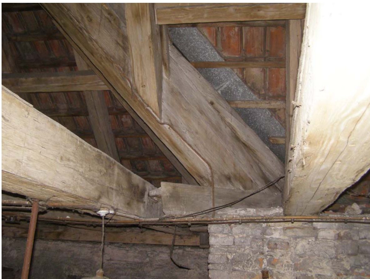
12. Poškozená úžlabní vazba č. 75
