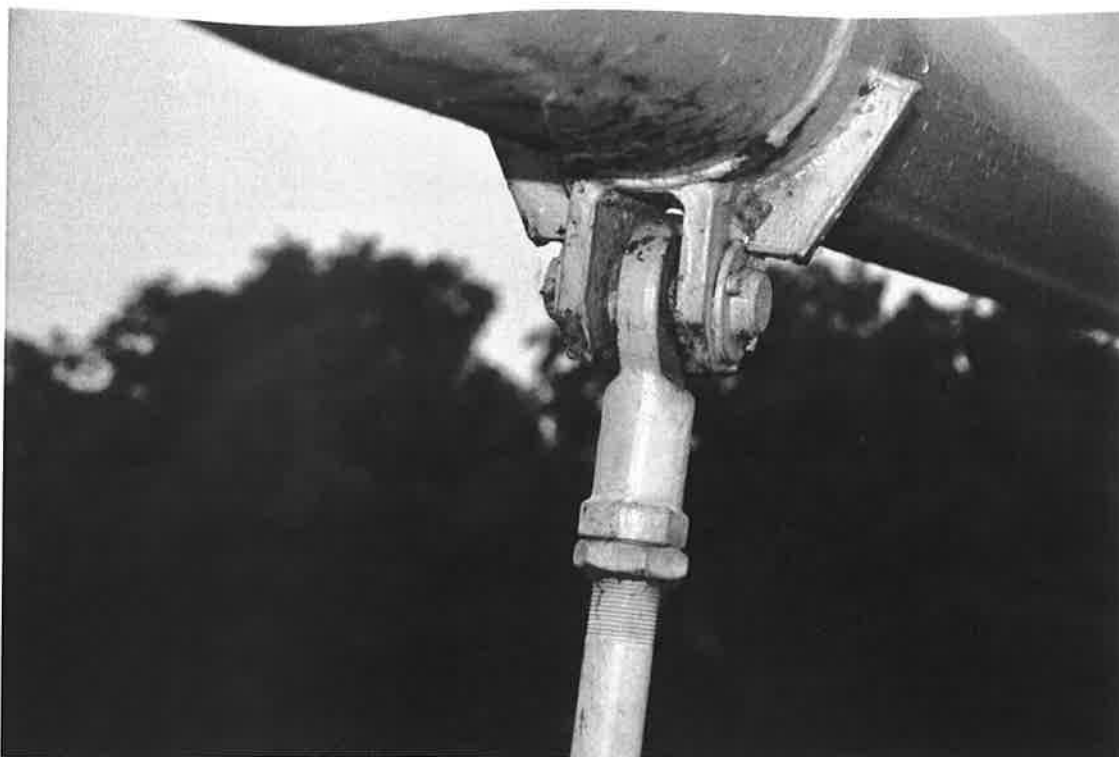
Kontrola koroze upevnění závěsů na visuté lano.
