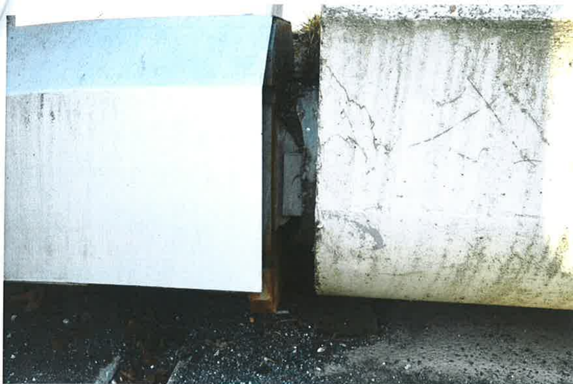
Vyfrézované válcové plochy tlumičů je třeba čistit a natřít vazelínou – opěra 1 návodní strana.
