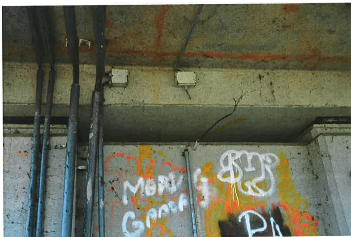
Detail líce opěry 1 na Kmochově ostrově s rozvody venkovního osvětlení, kabel uprostřed je utržený.
