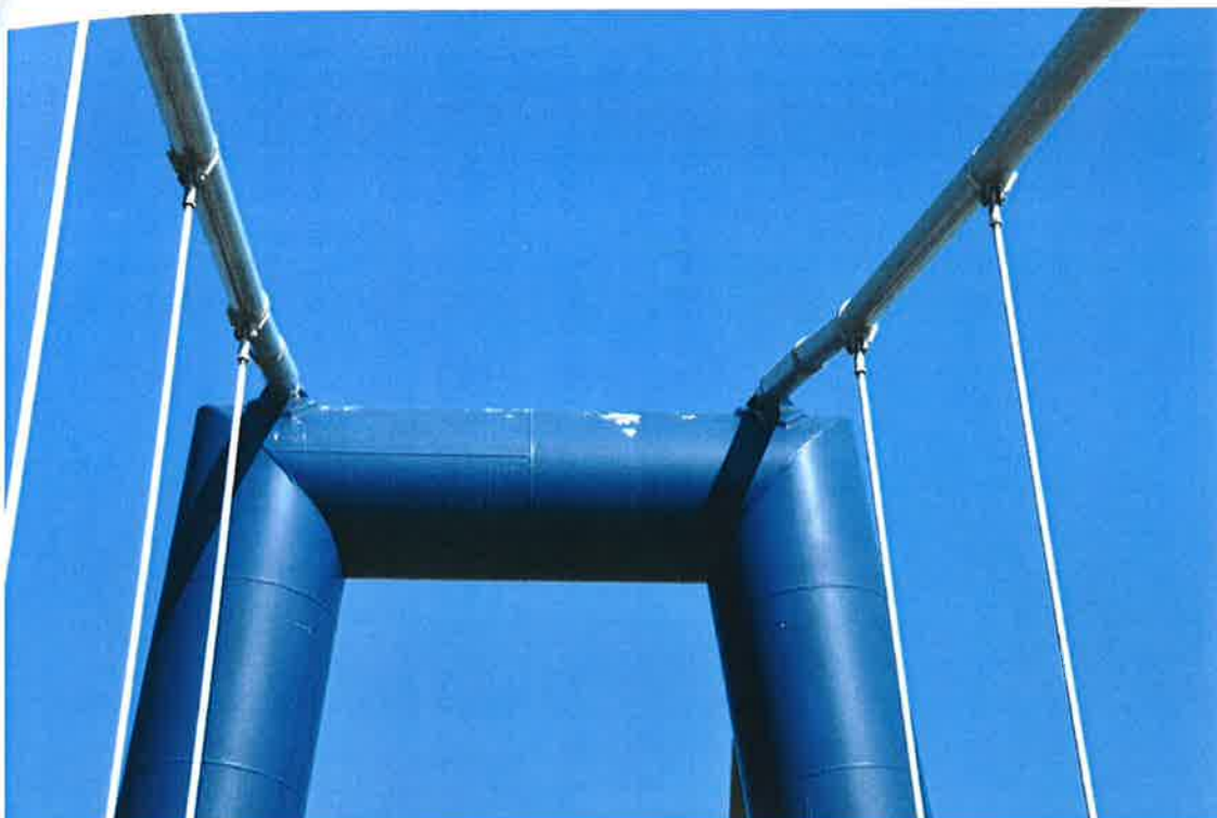
Horní část pylonu na pravém břehu Labe (v Zálabí) při pohledu od Kmochova ostrova, epoxidové nátěry se odlupují.
