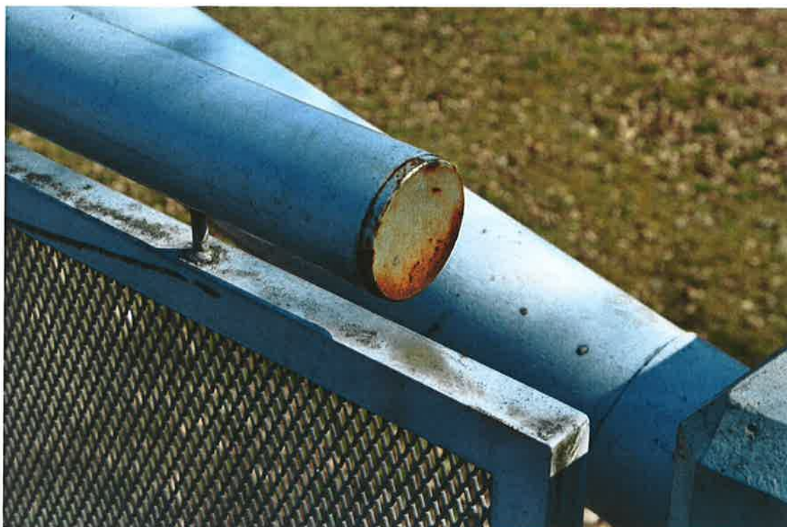
Koroze zakončení zábradlí u opěry 1 na návodní straně.
