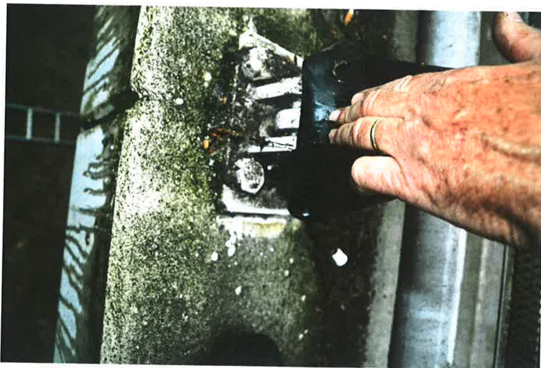
Kontrola koroze upevnění jednotlivých závěsů na dolním konci.
