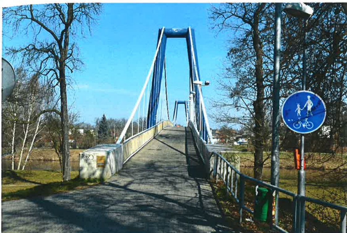
Celkový pohled na lávku při vstupu z Kmochova Ostrova. Nátěry na pylonu nahoře se odlupují.
