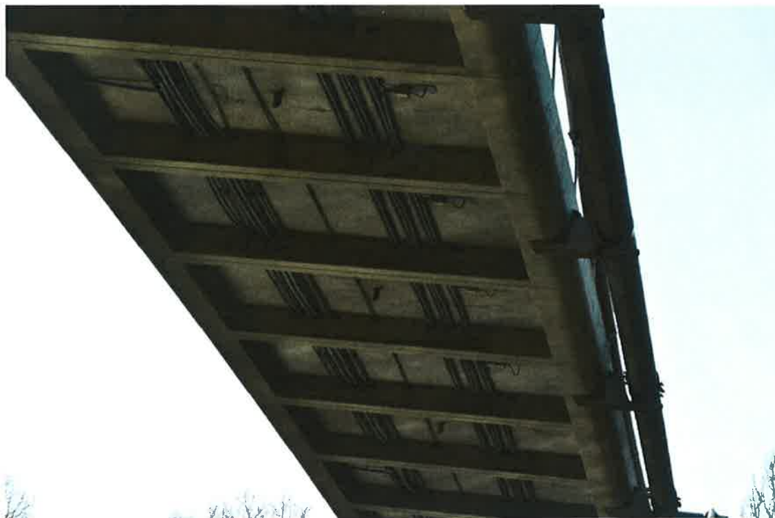
Mostovka má pohled absolutně suchý, bez zatékání.
