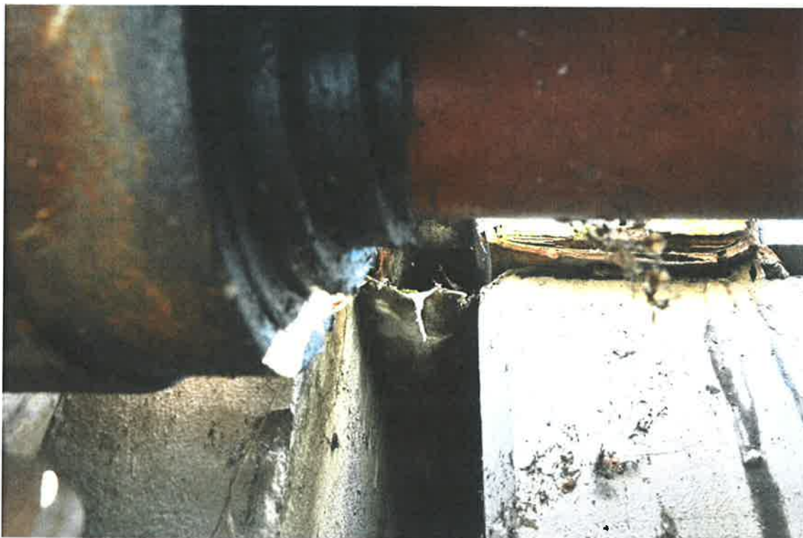
Spirálová pružina tlumiče při pohledu zespodu, nad ní končí kobercový dilatační závěr s okapnicí – návodní strana, opěra 1.
