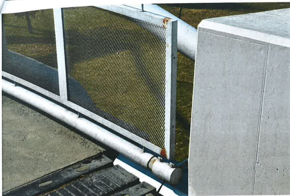
Koroze zakončení zábradlí u opěry 4 na povodní straně.
