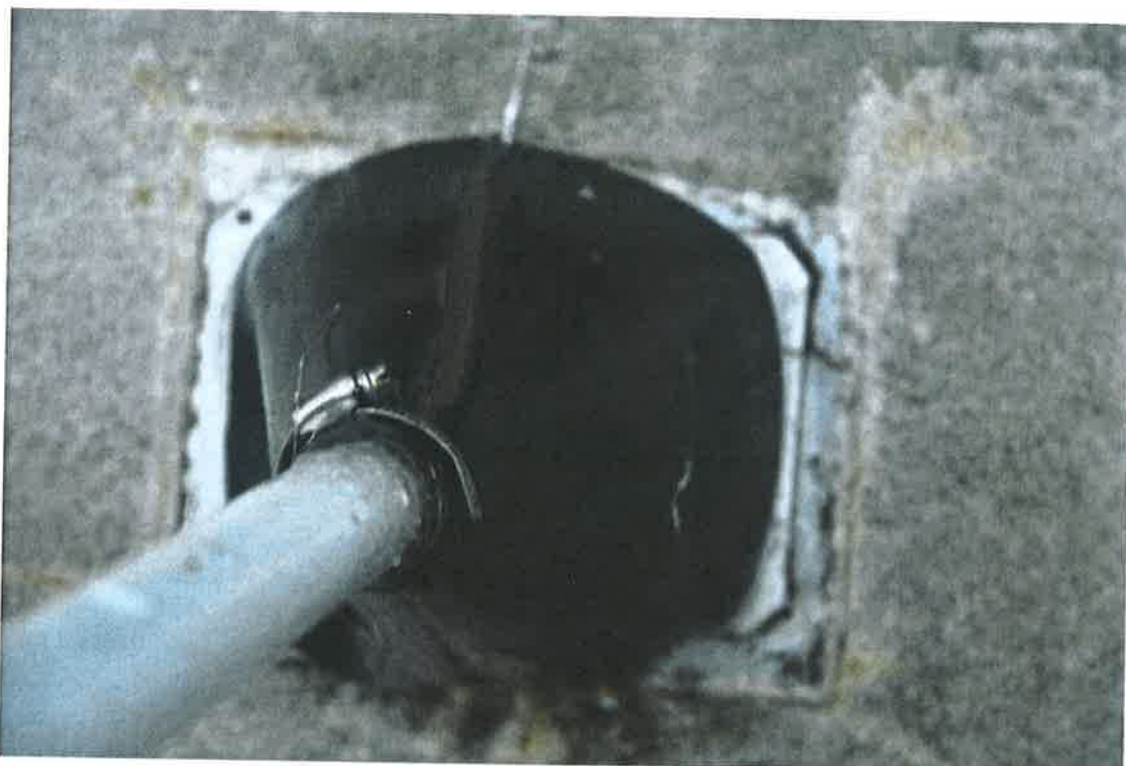
Gumové krytky upevnění závěsů jsou většinou prasklé (na této fotce je prasklina od hlavy šroubu objímky podél korodujícího ocelového lemu.
