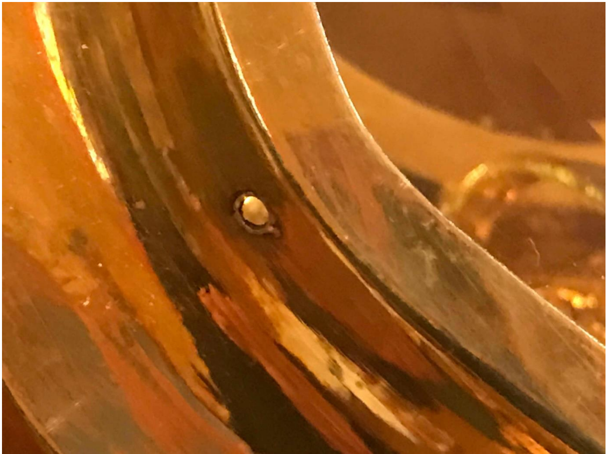
Chybějící šroub v jiné části zasklívacího profilu.
