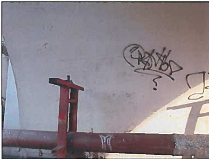
trhliny na spodním líci mostu
