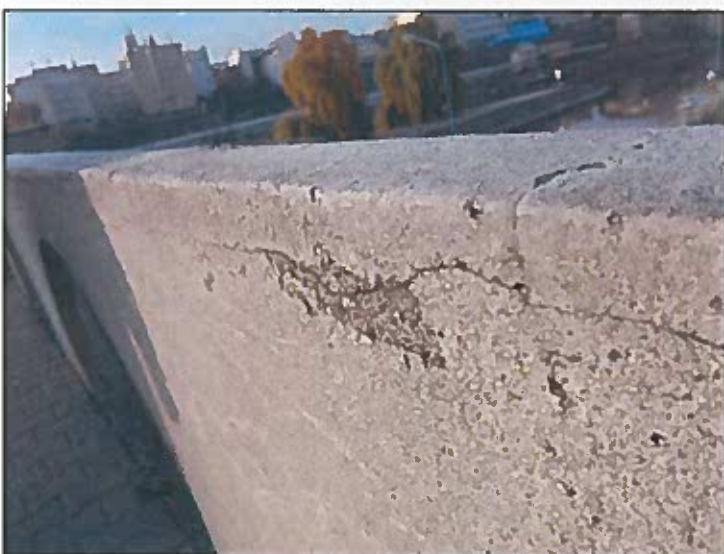
trhliny v madle zábradlí
