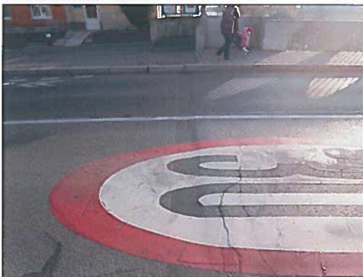
trhliny v krytu vozovky před EMZ
