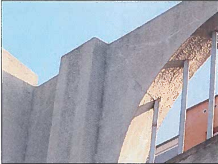
trhlina v zábradlí
