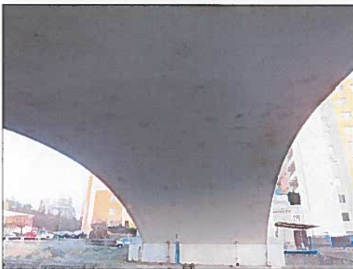
podhled obloukového pasu od O1, lokální poruchy sanaci nad korodující výztuží
