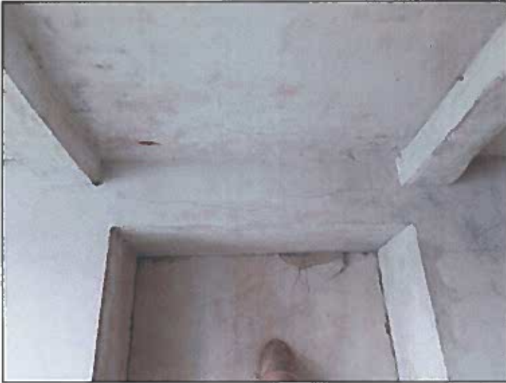
poruchy sanací u prvků mostovky u O2
