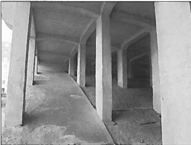
separace sanace nad korodující výztuží u sloupku podporujícího mostovku
