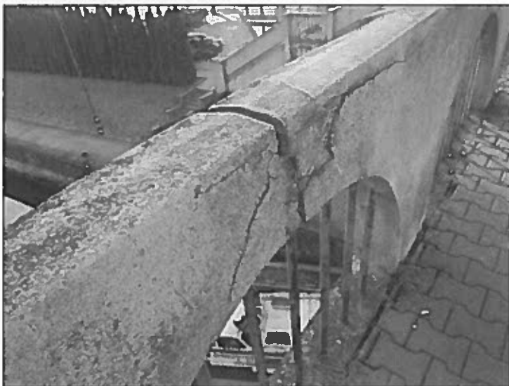
totální rozpad části zábradlí
