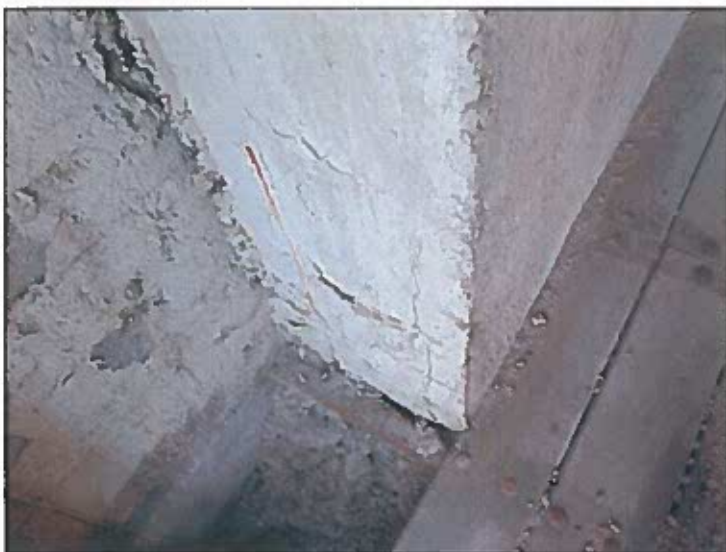
separace krycí vrstvy nad korodující výztuží u stěny nad O1
