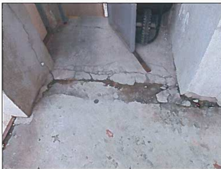
poruchy betonu pochozí vrstvy spodní lavy v místě dilatační spáry
