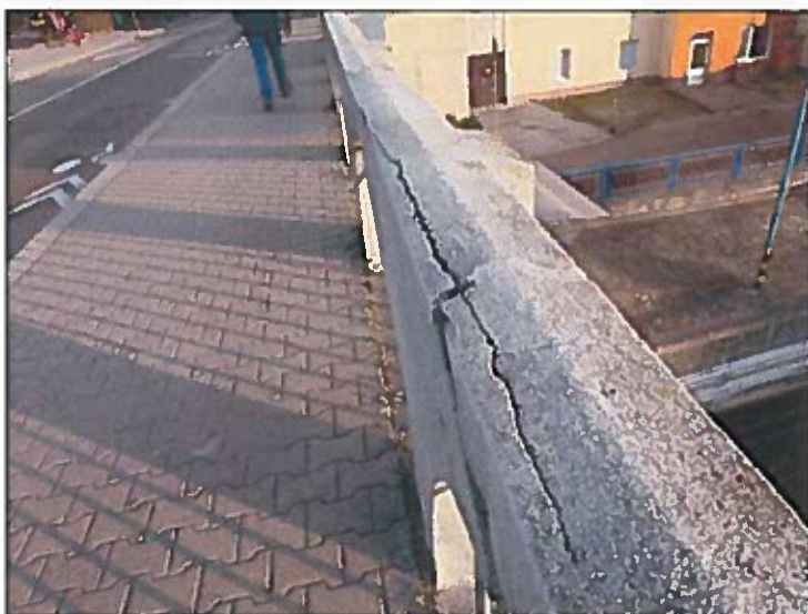
separace krycí vrstvy nad korodující výztuží v hraně madla zábradlí
