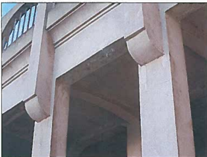
stopy po průsacích s výluhy pojiva na spodním lici krajního trámu mostovky
