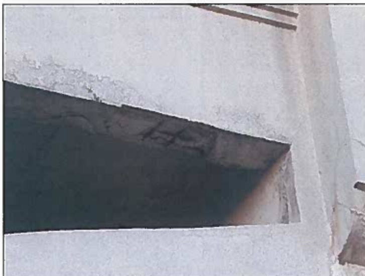
korozí obnažené výztuže krajního trámu mostovky
