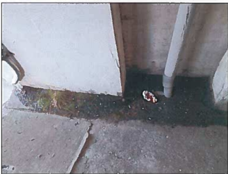
nánosy plné vody z odvodňovače u stěny nad O2
