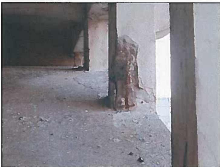
obnažená korodující výztužsloupku podporujícího mostovku
