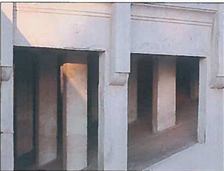
poruchy sanací u krajních sloupků a podélníků - typický stav
