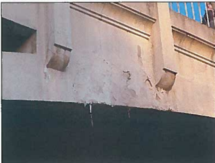
plošný průsak na pravý bok obloukového pasu netěsnou pracovní sparou
