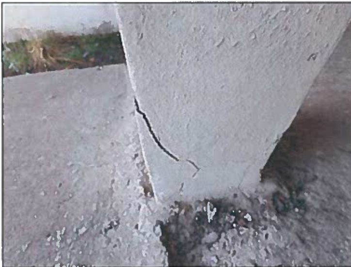
separace krycí vrstvy nad korodující výztuží v patě sloupku podporujícího mostovku
