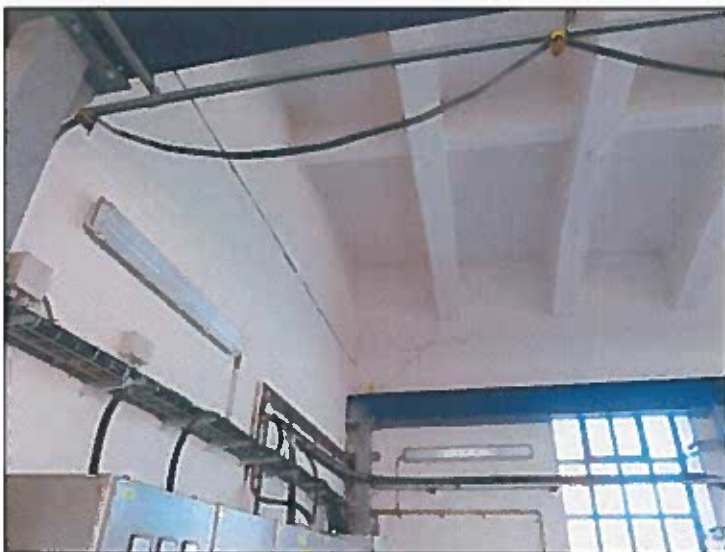
DTTO - průsak stěnou
