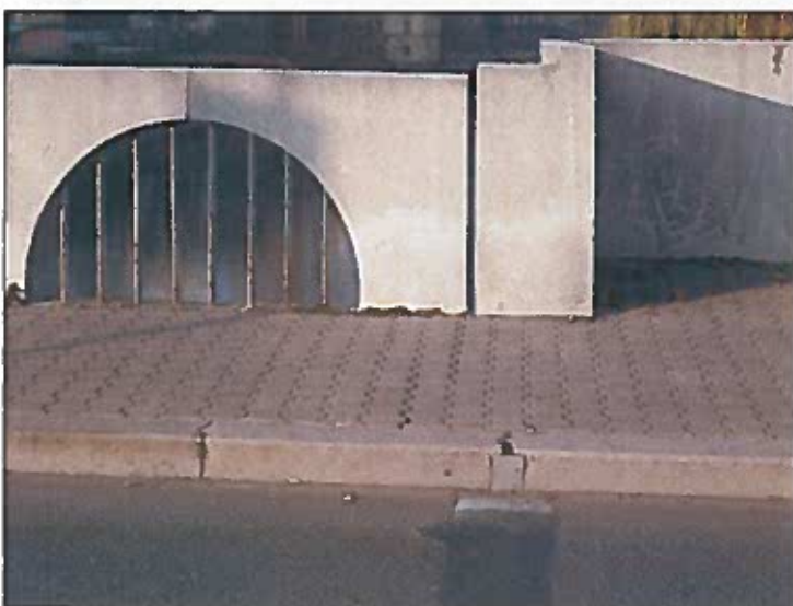
začínající deformace krytu chodníku v prostoru dilatační spáry
