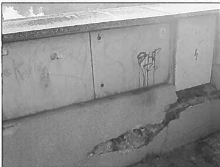
rozpad vyzdívky v okolí rozvaděče
