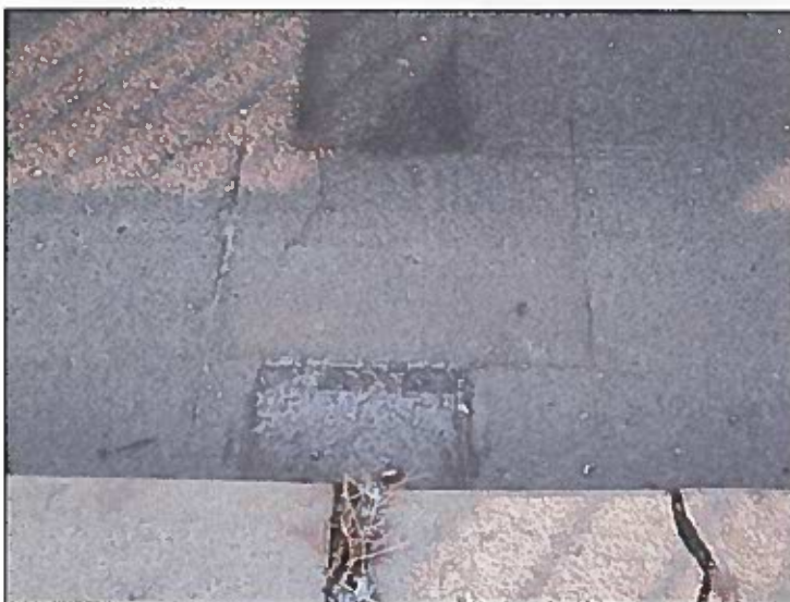
nekvalitně provedená oprava EMZ klasickým živčným krytem
