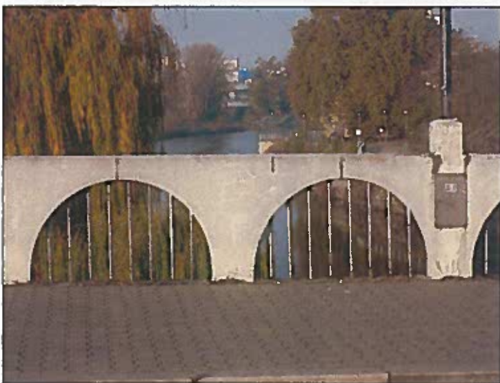
nepravidelné trhliny na lici zábradlí
