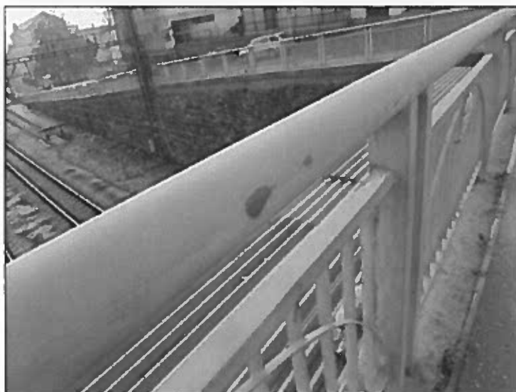
ojedinelá porucha protikoroziční ochrany zábradlí
