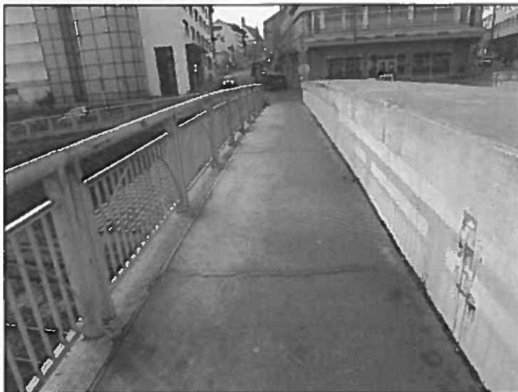
příčné uspořádání na chodníku, trhлина v chodníku, netěsná správa podél kolektoru
