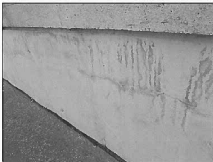
podélná trhлина s výluhy pojiva na stěně kolektoru
