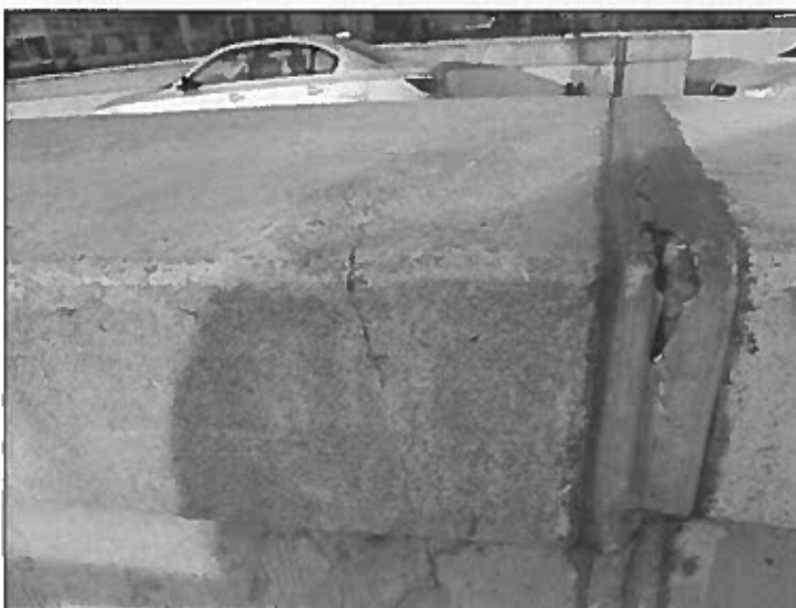
příčná trhlinka v kolektoru
