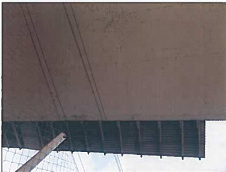
podhled protidotykových štítů
