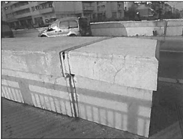
dilatační spára kolektoru pro převedení sílí je netěsná
