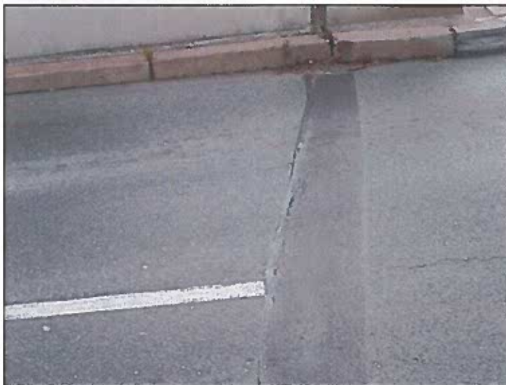
trhliny v MZ, otevřené pracovní spáry podél MZ nad O1
