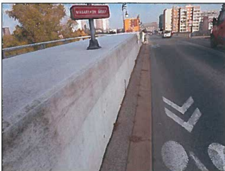
v krytu vozovky jsou vyjeté podélné koleje
