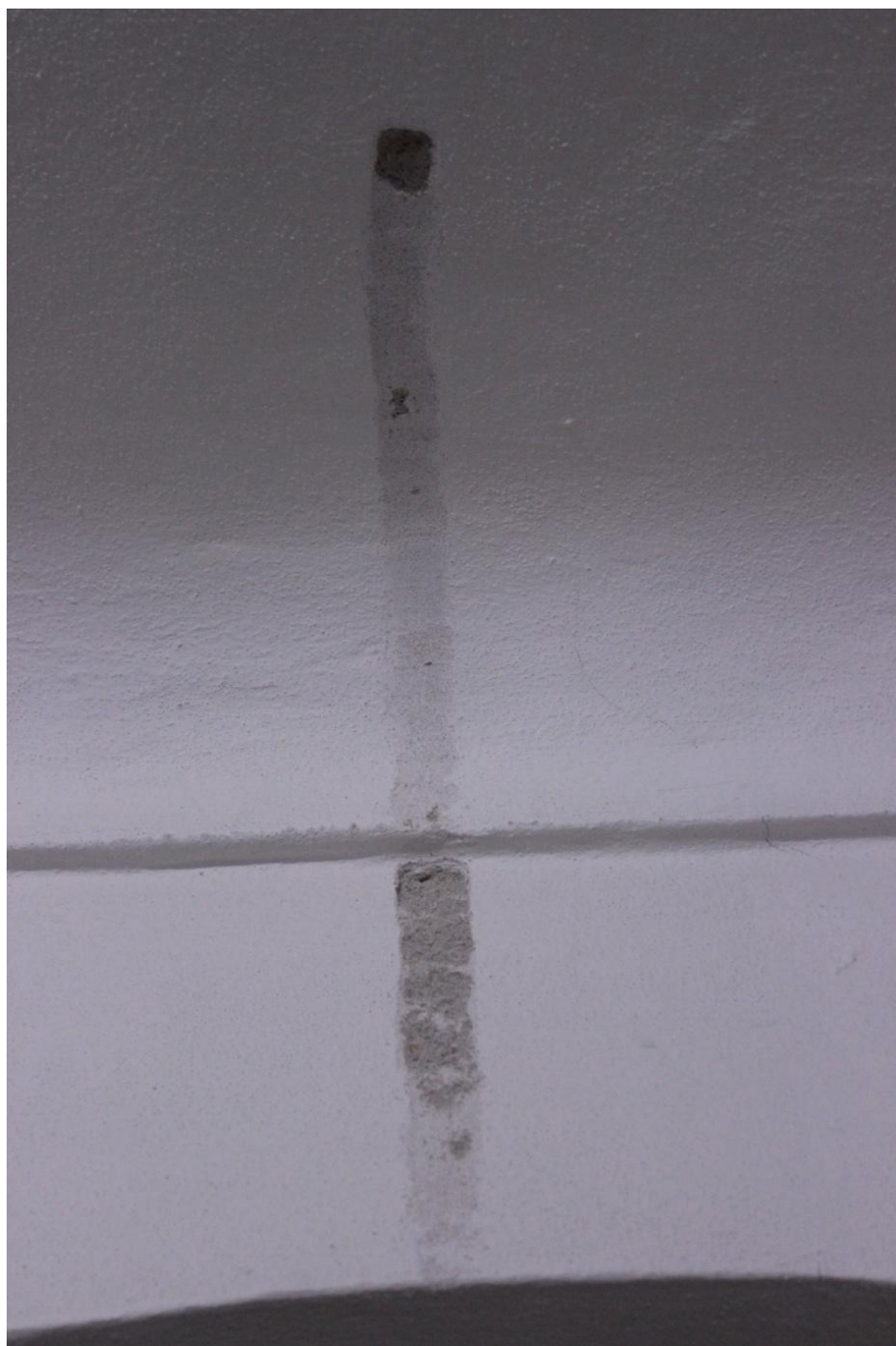
6.S.K.d./ Stratigrafie: 0-novodobé cementové omítky, 1-bílá -vápenný nátěr. 2- Současný stav. Místnost byla v minulosti opravována. Praskliny byly přestukovány.
