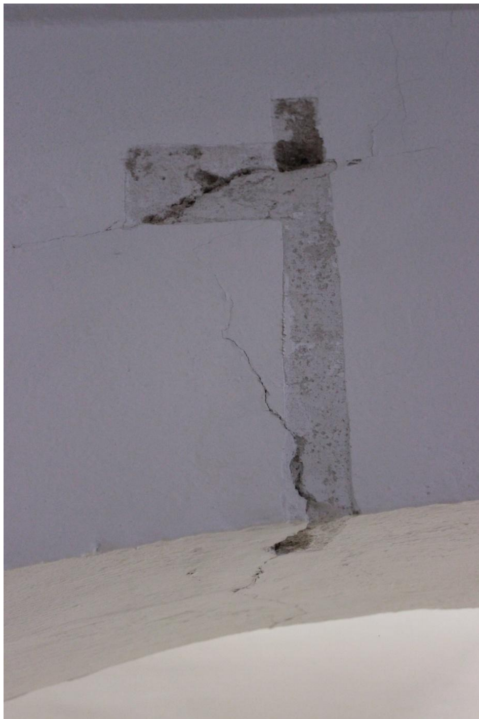
5.S.K.c./ Stratigrafie: 0-novodobé cementové omítky, 1-bílá -vápenný nátěr. 2- současný stav. Místnost byla v minulosti opravována. Praskliny byly přestukovány, oprava záklenku.
