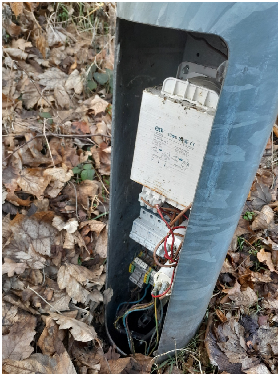
Foto č.1 – instalační otvor
