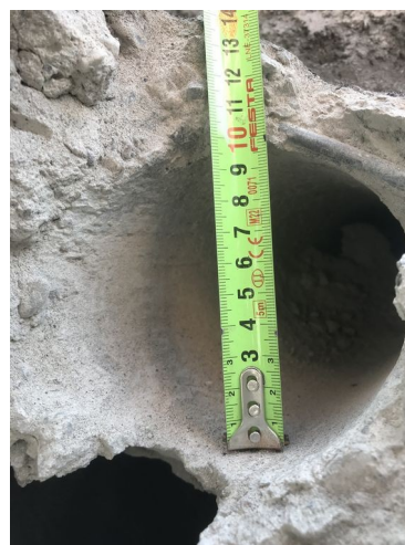
foto/13/ Zjištěná velikost dutiny ve stropním panelu
