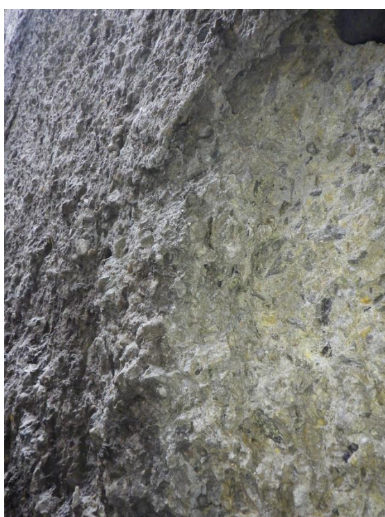
Obr. č. 5: detail stěny ve spodní části – povrch betonu se drolí, 20-30 mm lze lehce odstranit rukou, hlouběji nasoudrženém betonu je patrna poměrně jasně žlutá usazenina
